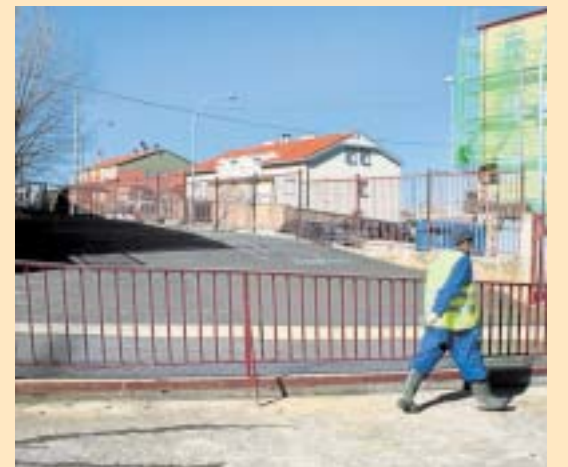
Rampa para el colegio Miguel Hernández. El Consistorio, dentro de sus labores de mantenimiento de los centros educativos, ha retirado un muro en malas condiciones y lo ha sustituido por una rampa en el colegio Miguel Hernández. /EÑE
